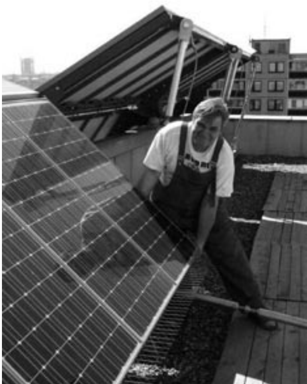
U solárních panelů na střeše Ministerstva životního prostředí.
