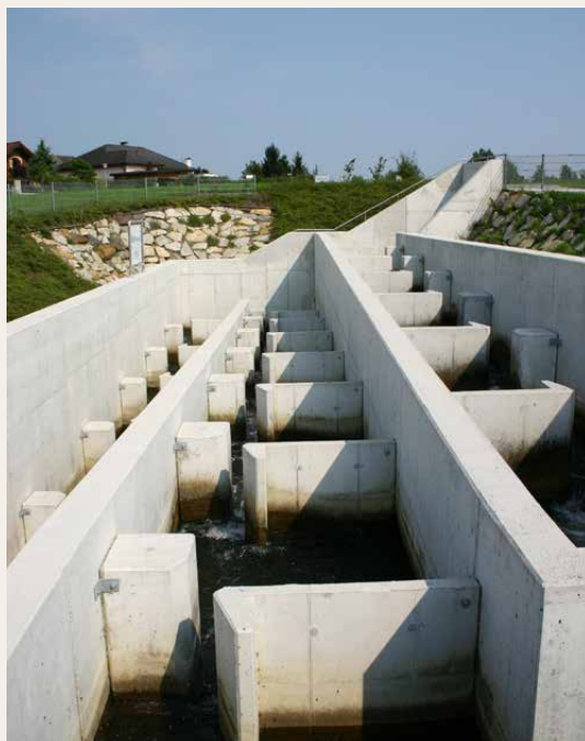
Vertikální šterbinový obtokový kanál, vodní elektrárna Greinsfurth na řece Ybbs, Rakousko. Příklad řešení rybího přechodu v omezeném prostoru. Rozdíl mezi hladinami je 8 m. Projekt byl spolufinancován v rámci programu EU LIFE Program*.
